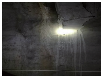
图3 箱梁内部渗水泛碱
