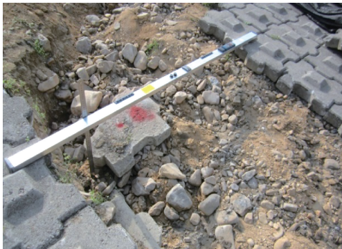
图 9 水库下游坝坡塌陷区域(107 m 到 96 m 高程)
