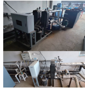
图1 低温热泵机组及U型蓄冰槽系统实物图
