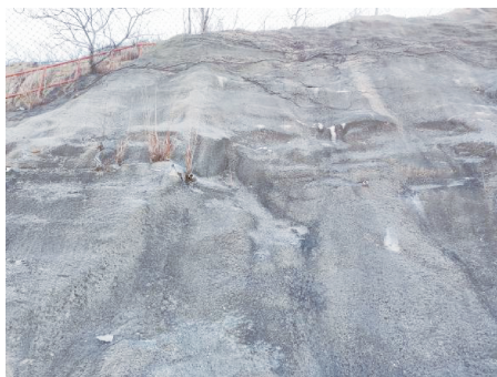
图 4 194 平台开裂坡面
