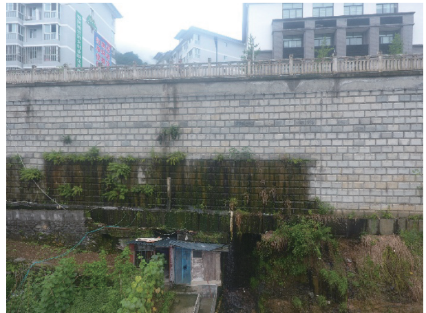
图 4 加筋土挡墙面板浸润现象
