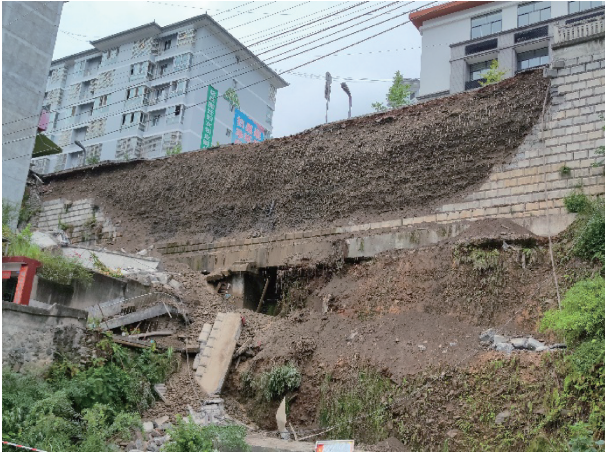
图 3 加筋土挡墙面板垮落
